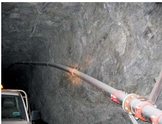
Рис. 9. Подземный транспорт закладочного материала по подвешенному в штреке трубопроводу
