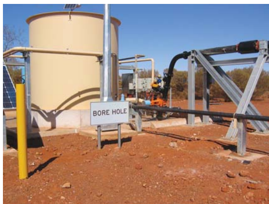
Рис. 6. Скважина для ввода закладочного трубопровода в подземные выработки
